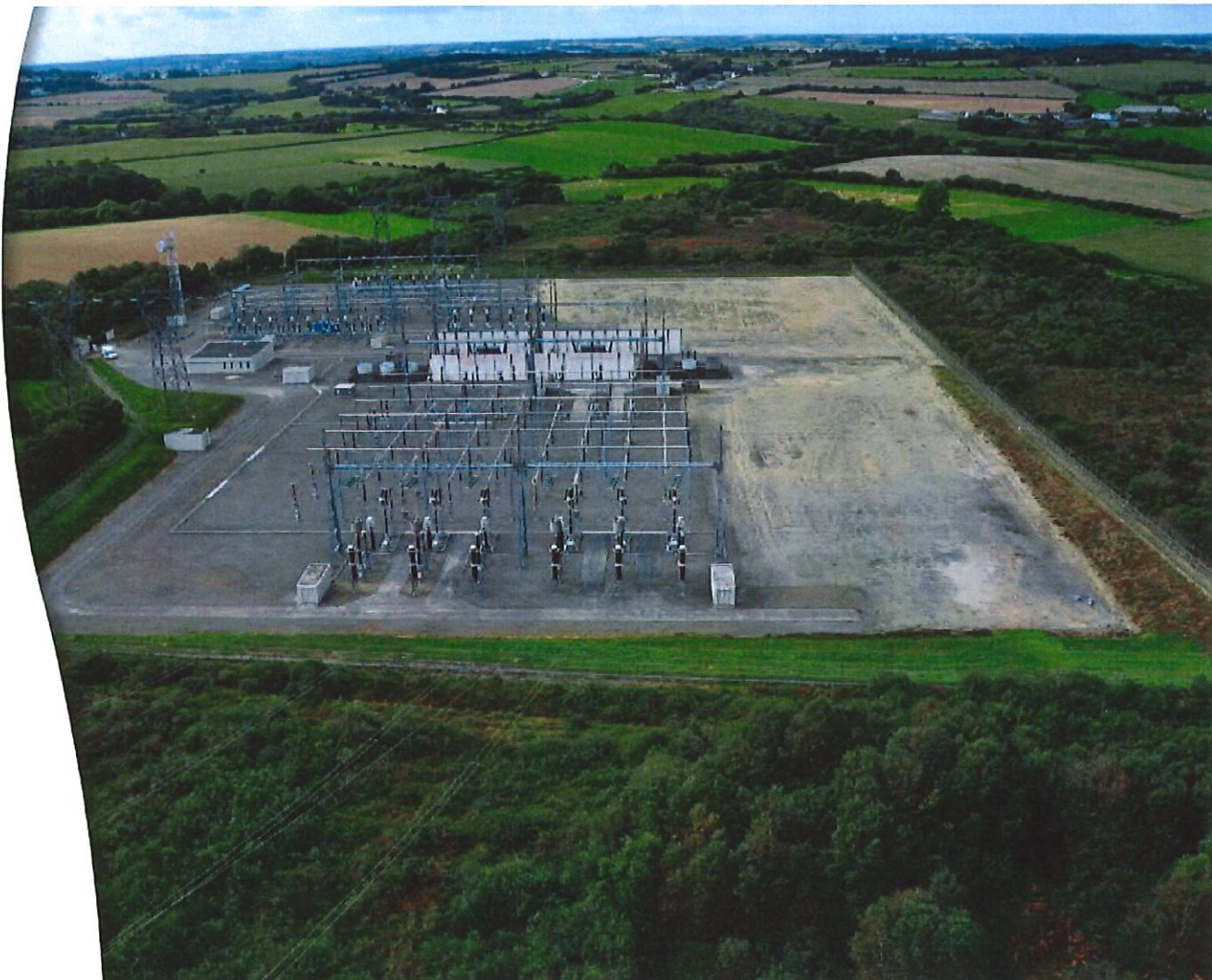
"poste électrique à Iscoat" photo RTE.
